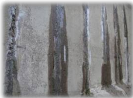
Рисунок 4 - Сочащиеся протечки через швы, трещины бетонной конструкции
